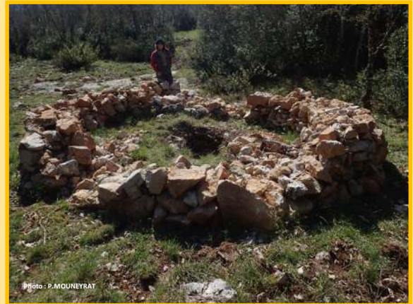
L'état du muret après l'épisode Cévenol
